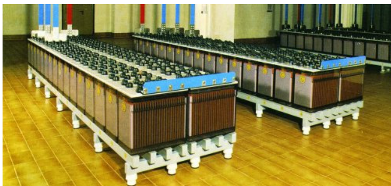
Obr. 35 – sestava staničních akumulátorů
